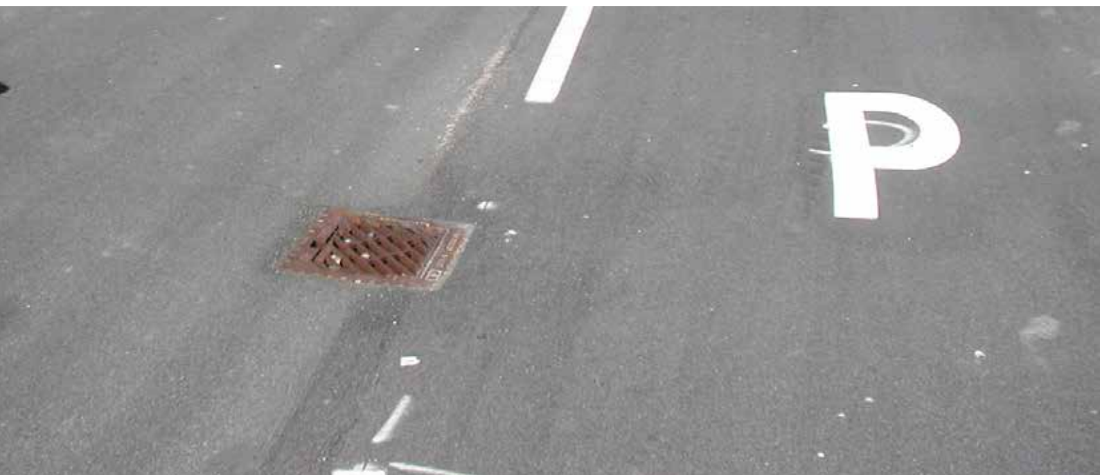
Regnvandsbrønd i vejanlæg
